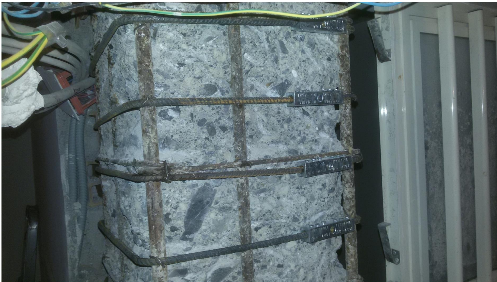
Vista testa di un pilastro cerchiato mediante staffe chiuse con manicotto in acciaio
